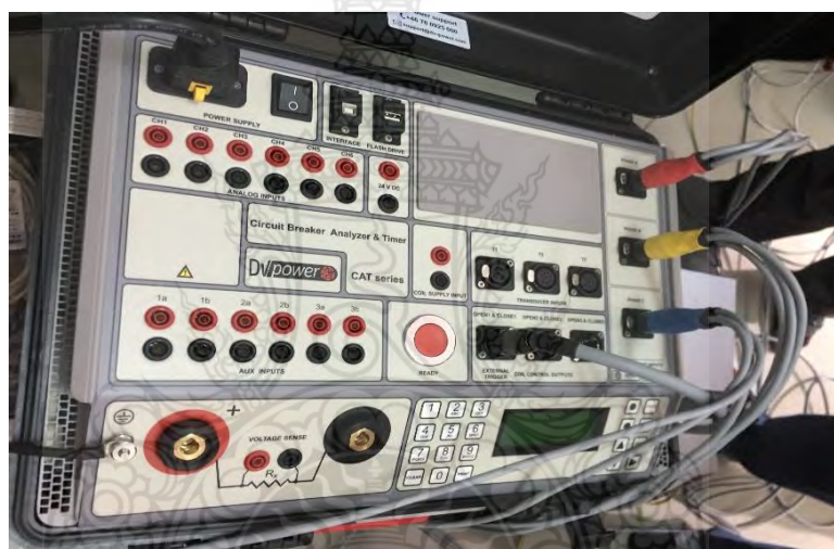
ภาพที่ 0-10 เครื่องตรวจวัดเวลาในการทำงานเซอร์กิตเบรกเกอร์
