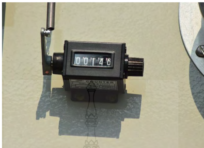
ภาพที่ 0-10 จำนวนครั้งการทำงานของเซอร์กิตเบรกเกอร์
