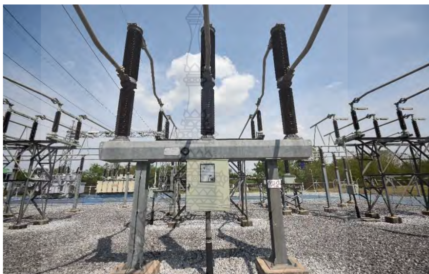
ภาพที่ 0-14 บริเวณโดยรอบของเซอร์กิตเบรกเกอร์
