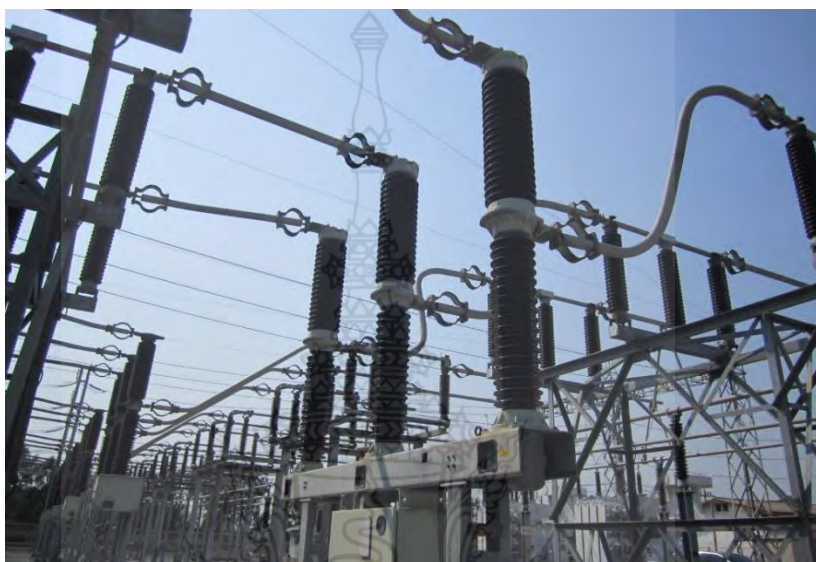
ภาพที่ 0-3 ลักษณะของ Live Tank Circuit Breaker
