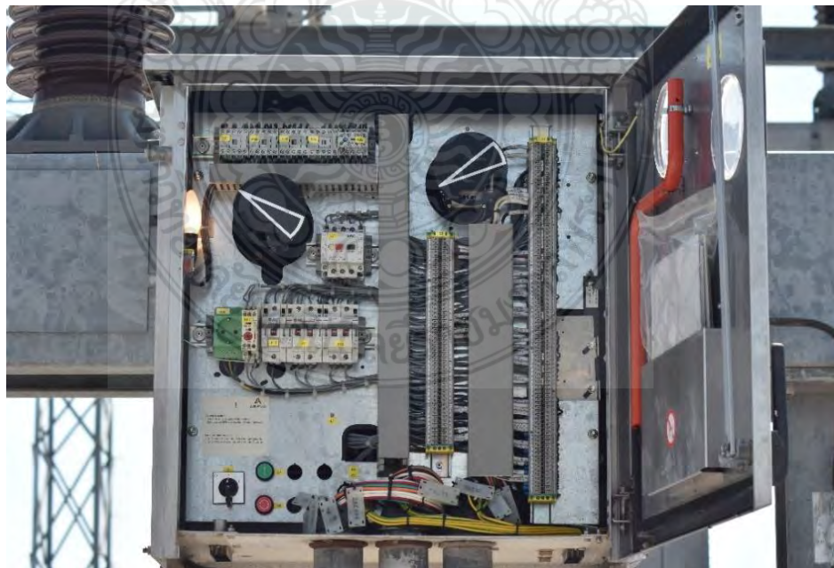
ภาพที่ 0-13 ตู้คอนโทรลของเซอร์กิตเบรกเกอร์
