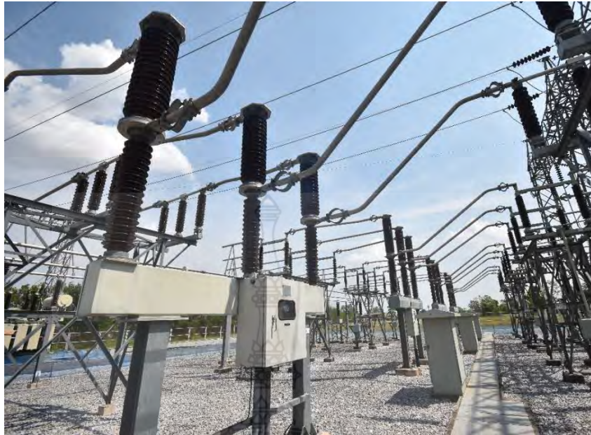
ภาพที่ 0-17 จุดต่อสายของเซอร์กิตเบรกเกอร์
