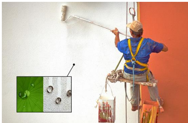
ภาพที่ 2.84 สีคล้ายกับพื้นผิวบัว เมื่อสีแห้งสิ่งสกปรกจะไม่สามารถเกาะติดอยู่ได้ จะช่วยให้อาคารนั้นดูสะอาดอยู่เสมอ
