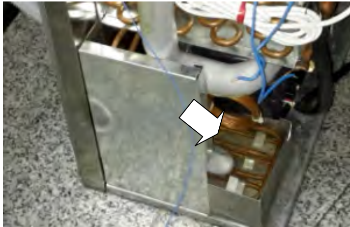
ภาพ 5.3 ถาดรองรับน้ำจากถาดใต้เครื่องระเหยของตู้แช่เครื่องที่ 2 มีน้ำล้นถาด
