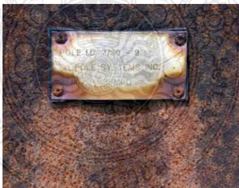
รูปที่ 2.5 การกัดกร่อนแบบ Galvanic Corrosion [23]
