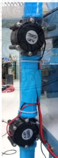
ภาพที่ 3.12 ติดตั้งมอเตอร์ผลิตกระแสไฟฟ้า เข้ากับท่อ PVC
