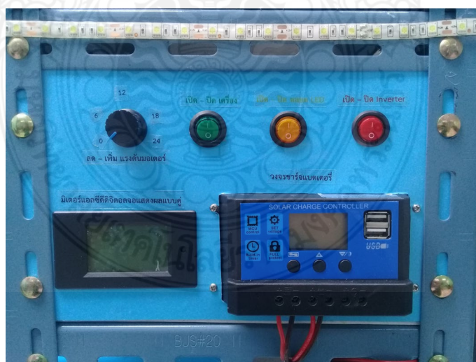
ภาพที่ 3.16 ติดตั้งโวลต์มิเตอร์ แอมป์มิเตอร์แอลซีดีดิจิทัลจอแสดงผลแบบคู่ ติดตั้งวงจรชาร์จ แบตเตอรี่ 12 V สวิตช์ 1 ทาง
