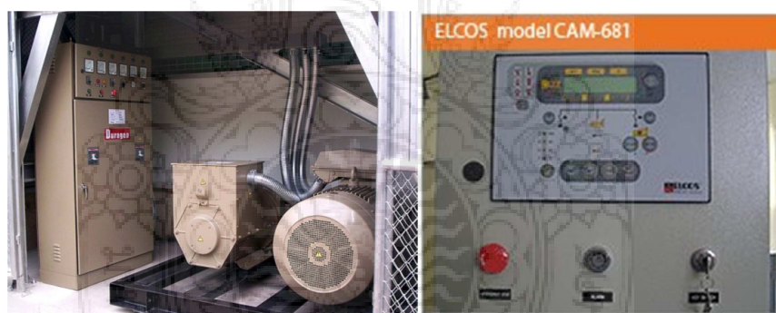
รูปที่ 2.18 อุปกรณ์ควบคุมและเครื่องกำเนิดไฟฟ้า
