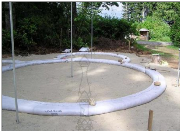
รูปที่ 2.1 ลักษณะการวางฐานรองรับโครงสร้างของบ้านพักอาศัยชั่วคราวที่สร้างด้วยระบบ Super Adobe ของสถาปนิก Nader Khalili (สุธี, 2550)
