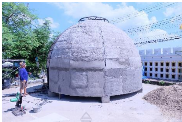
รูปที่ 4.59 อาคารสำเร็จรูปครึ่งทรงกลมที่มีการฉาบเบื้องต้นแล้ว
