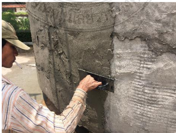
รูปที่ 11 ฉาบส่วนผสมในแบบหล่อที่มีการติดตั้งตะแกรงเหล็กไว้
