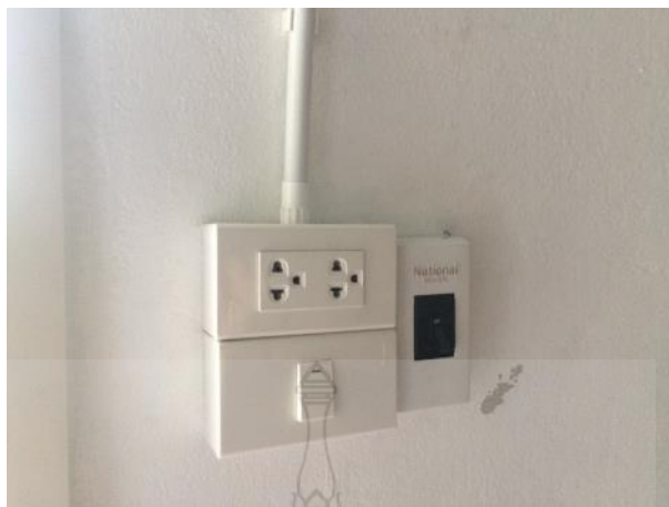
รูปที่ 4.74 การติดตั้งระบบไฟฟ้าของอาคารสำเร็จรูปครึ่งทรงกลม
