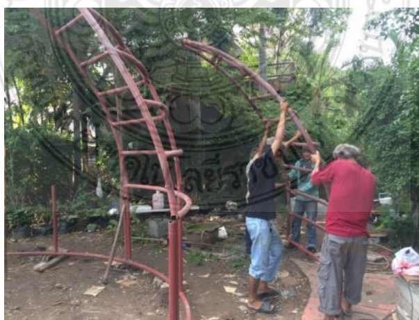
รูปที่ 4.25 การยกโครงสร้างผนังส่วนบนไปติดตั้งบนโครงสร้างผนังส่วนล่าง
