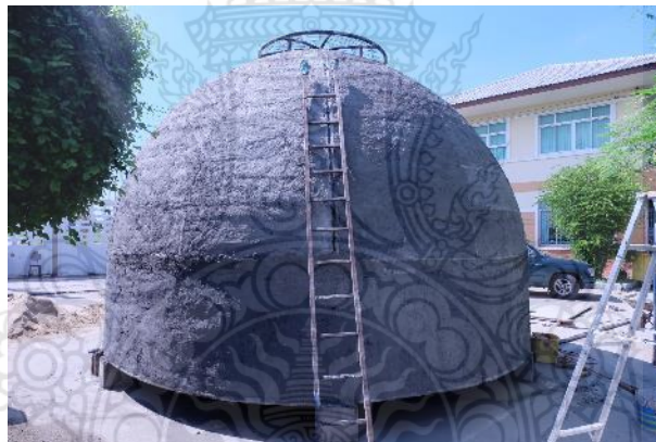
รูปที่ 20 อาคารสำเร็จรูปครึ่งทรงกลมที่มีการฉาบเบื้องต้นแล้ว
