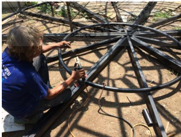
รูปที่ 4.39 การประกอบโครงสร้างหลังคาโดยการเชื่อมด้วยลวดเชื่อมไฟฟ้า
