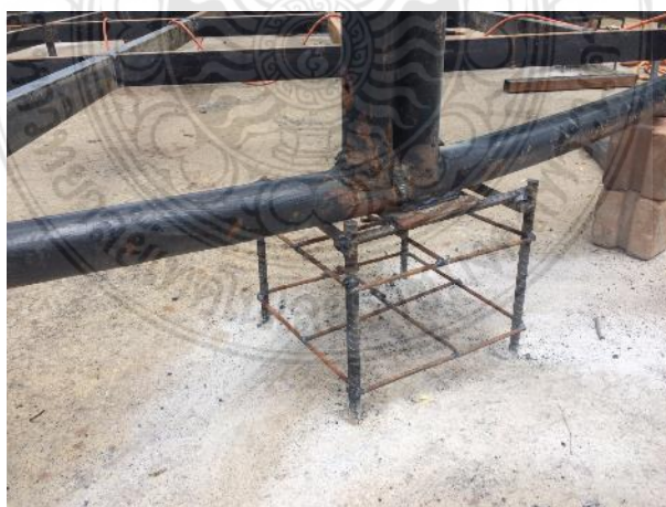
รูปที่ 4.52 ฐานของโครงสร้างอาคารสำเร็จรูป
