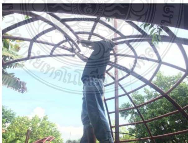
รูปที่ 4.31 การขันชะเนาะโครงสร้างผนังอาคารส่วนบน
