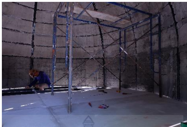
รูปที่ 4.62 การใช้ไม้ร้านช่วยในการก่อสร้าง
