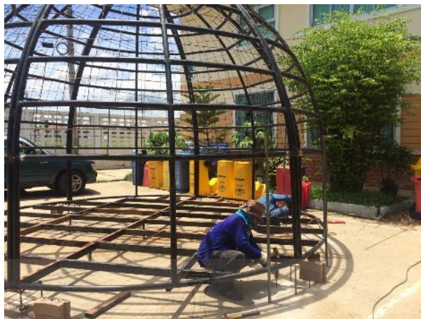
รูปที่ 4.53 การติดตั้งของโครงสร้างอาคารสำเร็จรูป
