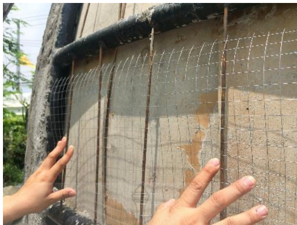
รูปที่ 3.30 การติดตั้งแผ่นไม้อัด เหล็กเส้นกลม และเหล็กตะแกรง สำหรับหล่อแผ่นเปลือกอาคาร
