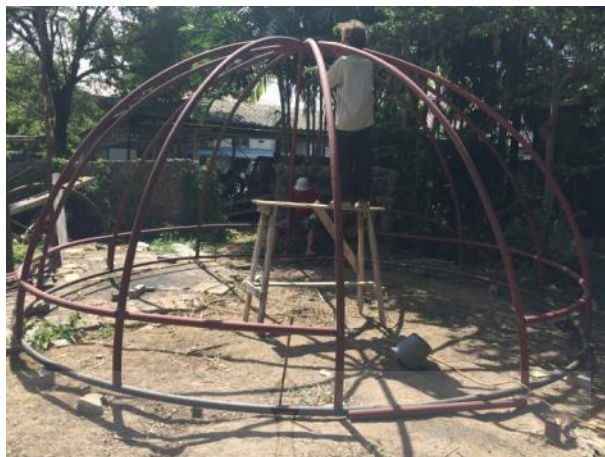
รูปที่ 4.11 โครงสร้างผนังส่วนบนของอาคารสำเร็จรูปทรงครึ่งทรงกลม
