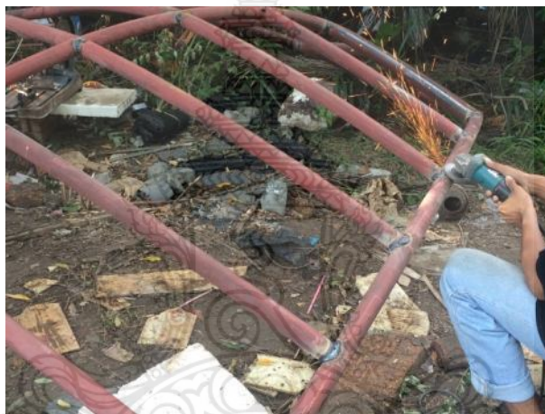
รูปที่ 4.18 การตกแต่งรอยเชื่อมของโครงสร้างด้วยเครื่องเจียรแบบมือถือ
