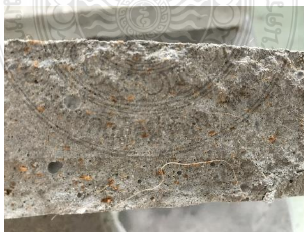
รูปที่ 4.48 ลักษณะแผ่นตัวอย่างเปลือกอาคารที่วิบัติจากทดสอบความต้านทานแรงดัด
