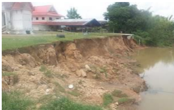
รูปที่ 1.5 ตลิ่งพังทลายจากการดูดทรายในแม่น้ำ (ผู้จัดการออนไลน์, 2557)
