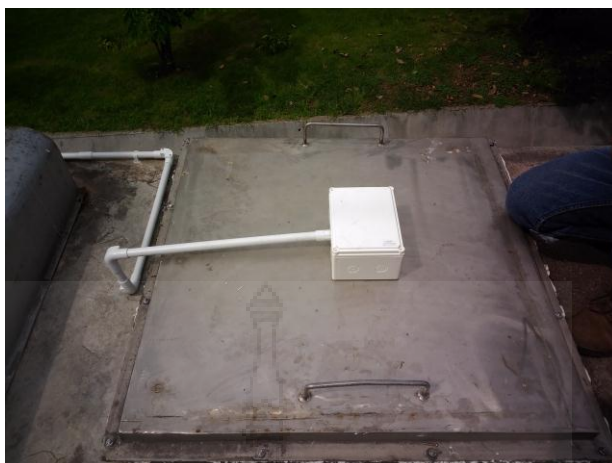
ภาพ 4.6 เครื่องวัดระดับปริมาณน้ำที่ติดตั้งบนบ่อเล็ก (GT BTG600) เสร็จแล้ว
