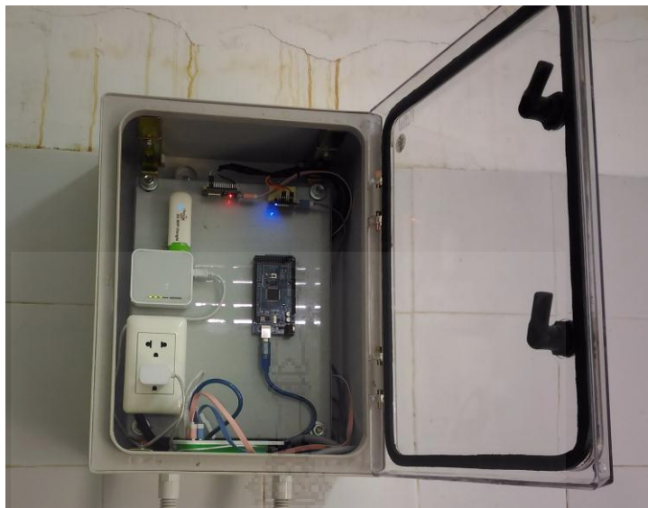
ภาพ 4.8 เครื่องรับส่งสัญญาณแบบไร้สายที่ติดตั้งอยู่เหนือบ่อเสร็จแล้ว
