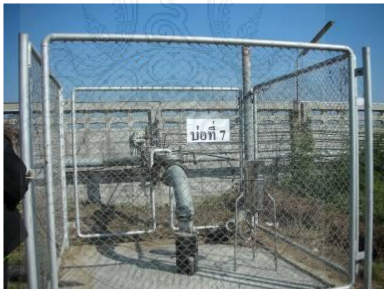
ภาพ 2.7 บ่อน้ำบาดาลย่อย (บ่อที่ 7) ที่มา : ประสิทธิ์ (2559)
