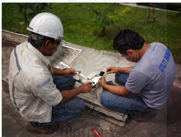
ภาพ 4.5 การติดตั้งเครื่องวัดระดับปริมาณน้ำบนบ่อเล็ก (GT BTG600)
