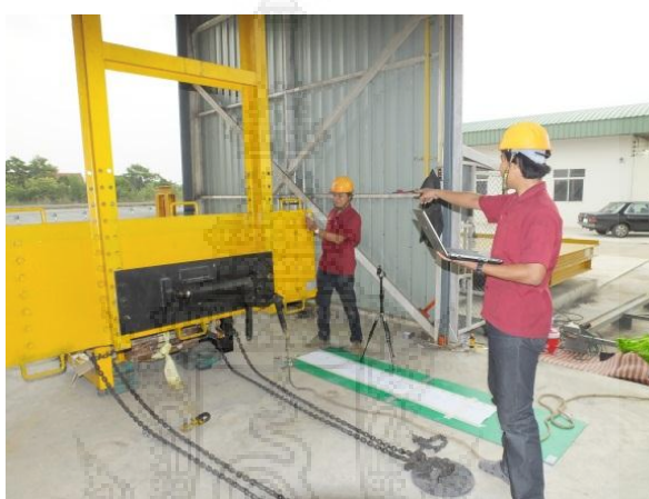
รูปที่ 3.25 การติดตั้งอุปกรณ์วัดมุมแบบดิจิตอล
