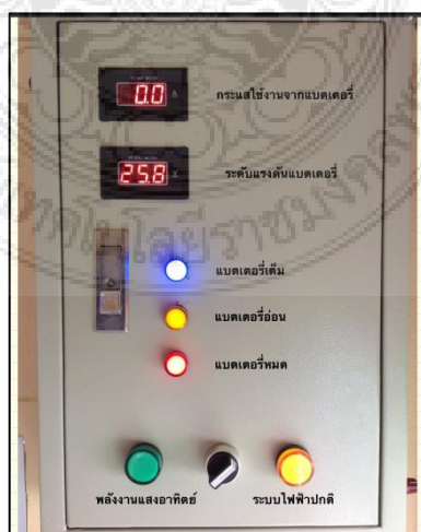
ภาพที่ 3.25 ชุดควบคุมเสร็จสมบูรณ์
