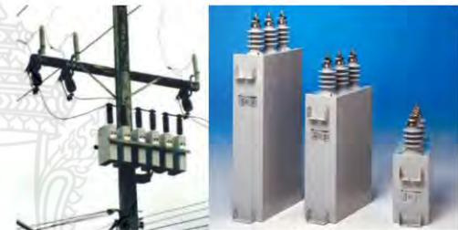
รูปที่ 2 ชุดคาปาซิเตอร์แบบคงที่ที่ติดตั้งในระบบจำหน่าย
