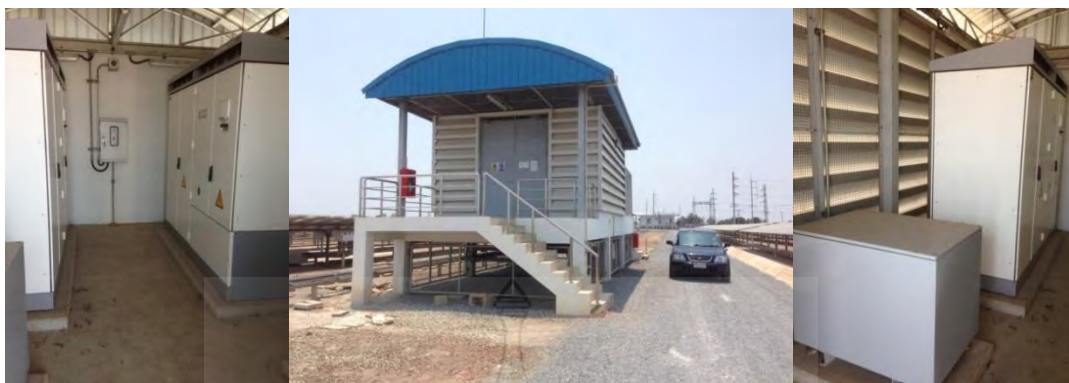
ภาพ 4.6 ภายในอาคารของสถานีไฟฟ้าที่ไม่มีพื้นที่วางที่เพียงพอ
