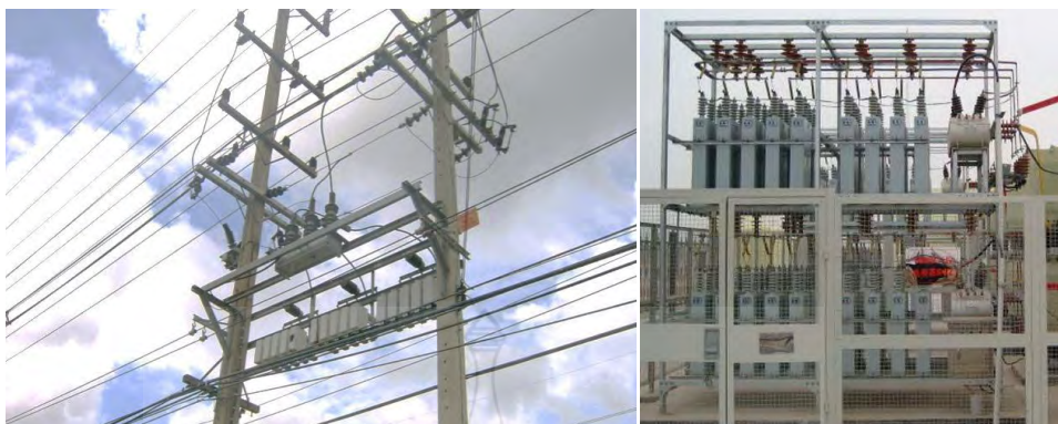
ภาพ 2.8 คาปาซิเตอร์สำหรับระบบไฟฟ้าแรงดันกลาง
