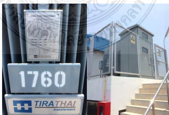
รูปที่ 4.5 หม้อแปลงไฟฟ้า 3 เฟส 1760 กิโลวัตร์
